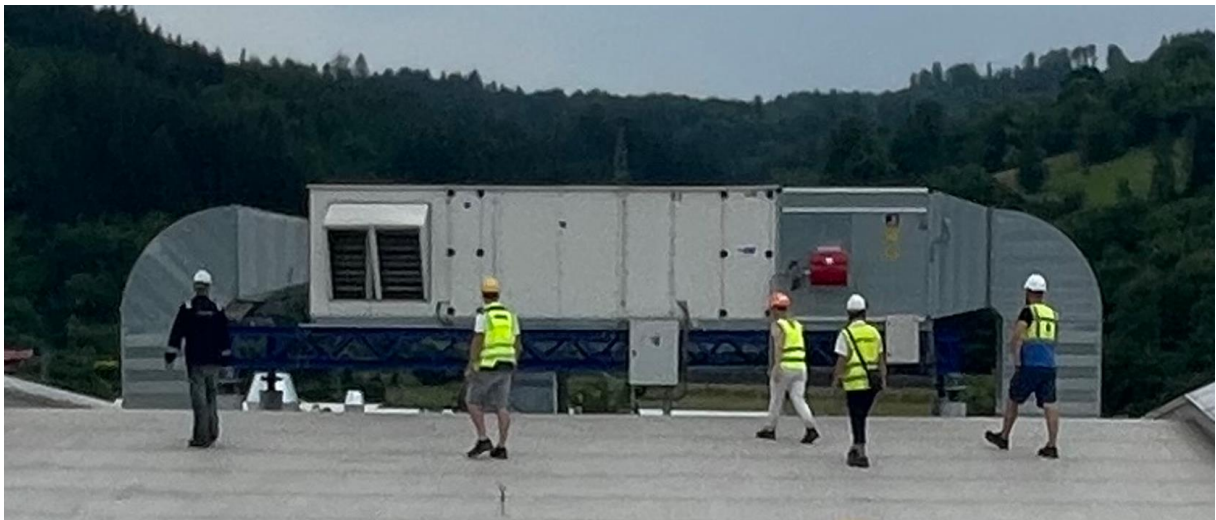
VZT jednotka s výkonem 24 000m 3 /hod, elektrický ohřev
