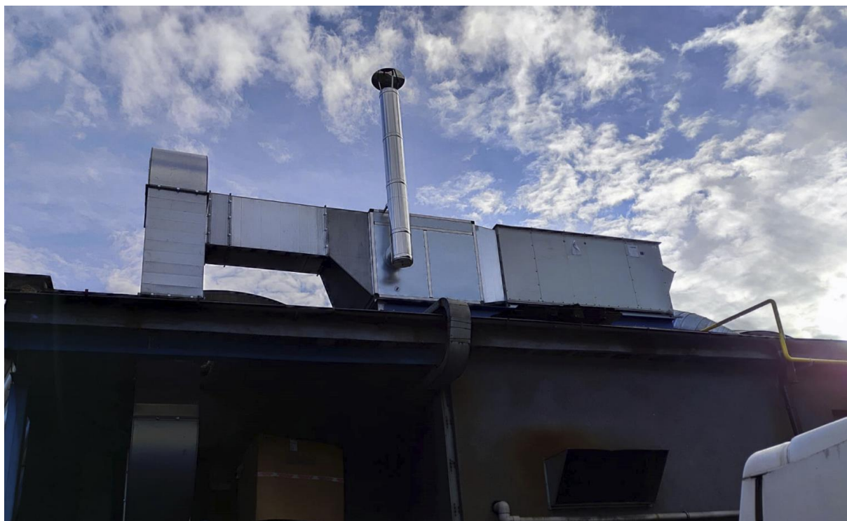
VZT jednotka s výkonem 30 000m 3 /hod, plynový hořák
