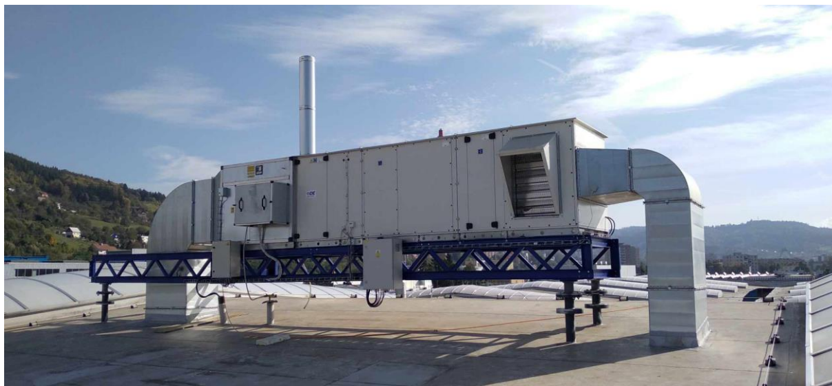
VZT jednotka s výkonem 15 000m 3 /hod, plynový hořák
