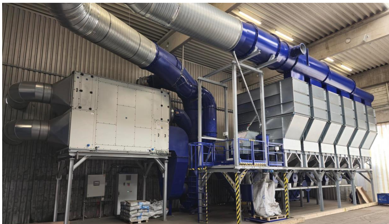
Obrázek 4 Filtrační zařízení s přívodní rekuperační jednotkou
